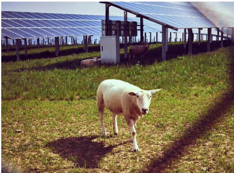
Abbildung 2: Beispiel für eine Freiflächen-Photovoltaikanlage mit Schafbeweidung
