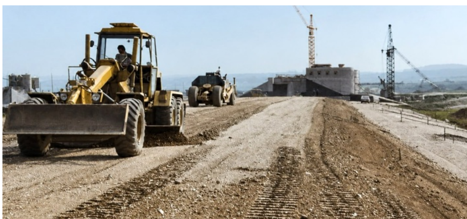
Abschnittsweise entstand der mehrschichtige Damm in den Jahren 1973 bis 1975, bestehend u.a. aus abdichtenden Elementen (Kerndichtung, Dichtungsteppich, Schmalwand) und dem aufliegenden Stützkörper.
